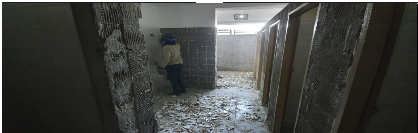
DEMOLIÇÃO DE REVESTIMENTO COM RETIRADA DE VASOS, LAVATÓRIO E MICTÓRIO DO SANITÁRIO DOS ALUNOS
