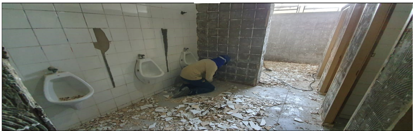
DEMOLIÇÃO DE REVESTIMENTO COM RETIRADA DE VASOS, LAVATÓRIO E MICTÓRIO DO SANITÁRIO DOS ALUNOS
