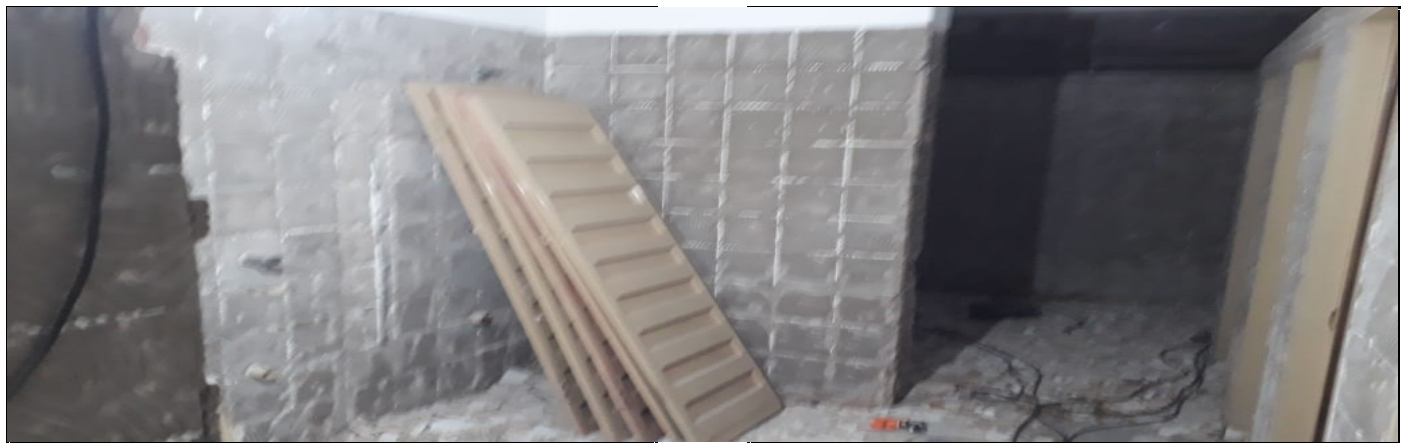
DEMOLIÇÃO DE REVESTIMENTO COM RETIRADA DE VASOS, LAVATÓRIO E MICTÓRIO DO SANITÁRIO DOS ALUNOS
