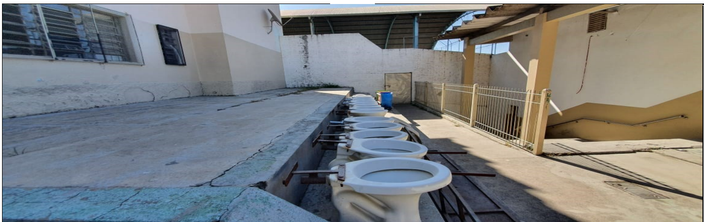
DEMOLIÇÃO DE REVESTIMENTO COM RETIRADA DE VASOS, LAVATÓRIO E MICTÓRIO DO SANITÁRIO DOS ALUNOS
