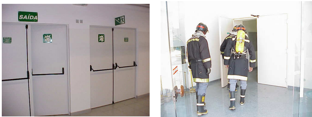
Figura 6 - Saída de emergência. Norma: Fonte: DSCI- CBPMESP
