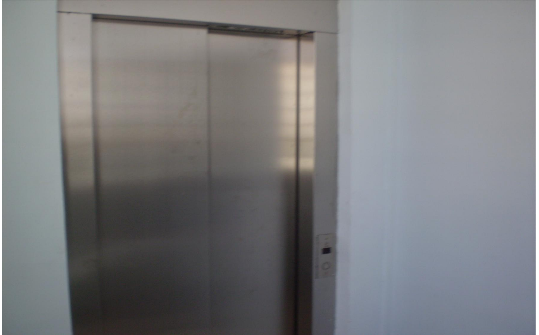
ELEVADOR DA UNIDADE ESCOLAR
